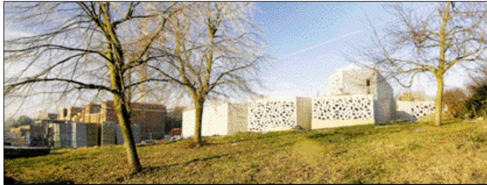
Manuelle Gautrand, cantiere di estensione del Lille Métropole Musée d'art moderne (dicembre 2007; foto Max Lerouge/LMCU)
